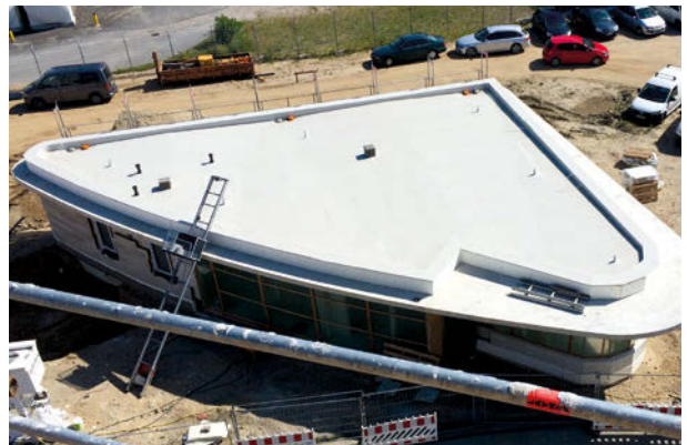
Stadtwerke Lübeck ExtruPol Dachabdichtung 2.800m 2
